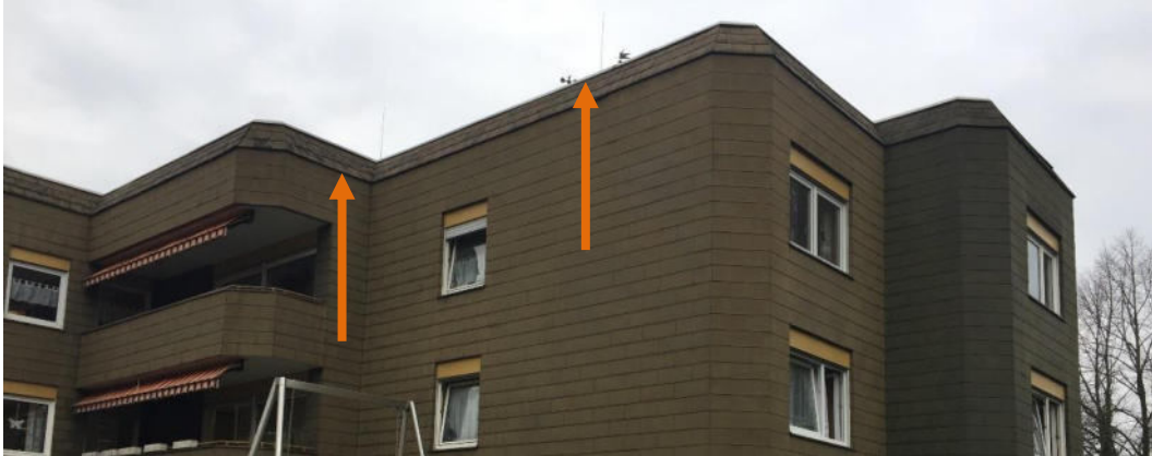
Abbildung 5.1.2-1. Potenzielle Fledermausquartiere unter den Attikaabdeckungen an Gebäuden der Einrichtung "Martinshaus".
