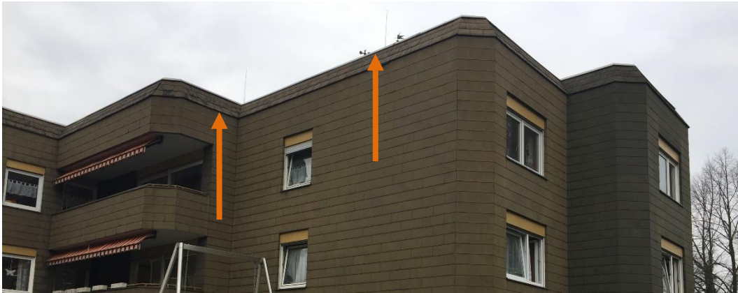
Abbildung 5.1.2-1. Potenzielle Fledermausquartiere unter den Attikaabdeckungen an Gebäuden der Einrichtung "Martinshaus".
