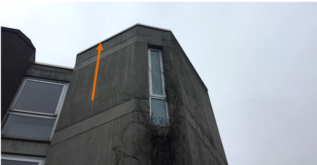
Abbildung 5.1.2-2. Potenzielle Fledermausquartiere unter der Attikaabdeckung eines Gebäudes der Einrichtung "Martinshaus".
